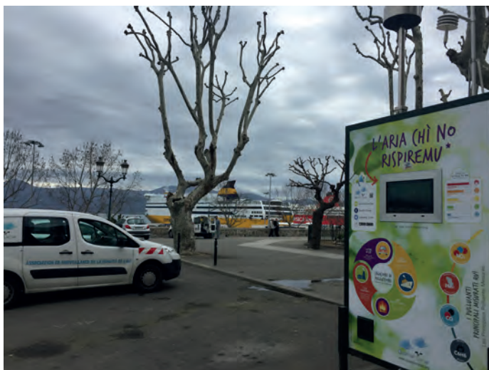
Figure 158 - Photographie de la nouvelle station de surveillance d'Abbatucci et de son habillage pédagogique.
